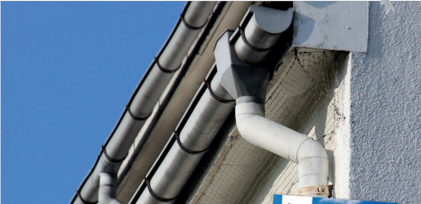
Strafbare Handlung: Netze an einem ehemaligen Brutplatz von Mehlschwalben. Die Kolonie ist nun erloschen. © Ina Ebert
