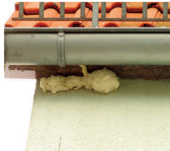
Durch Bauschaum verschlossene Einflugöffnung. © Karsten Peterlein
