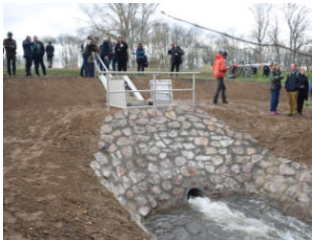
Einlaufbauwerk Burgauenbach. Foto: Karolin Tischer
