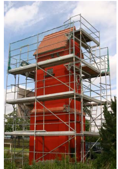
Trafohaus Mahlitzsch Für Turmfalke, Schleiereulen, Fledermäuse und sonstige gebäudebewohnende Arten Ausbau 2005
